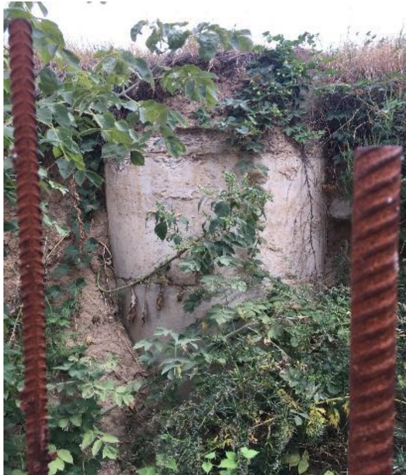
Фото 20. Элементы систем наружных инженерных сетей, колодец
