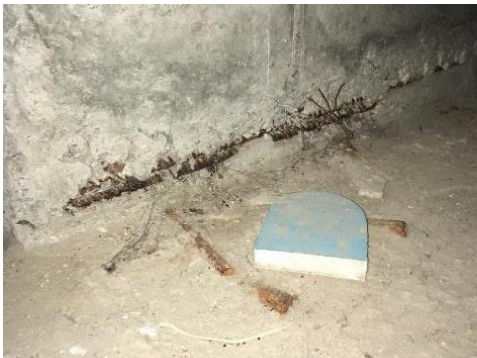
Фото 21. Дефекты. Отсутствие защитного слоя бетона, коррозия арматуры.
