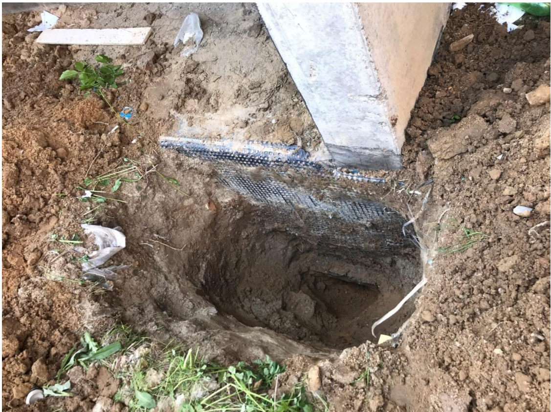
Фото 43. 18-этажная часть. Шурф по оси Г.
