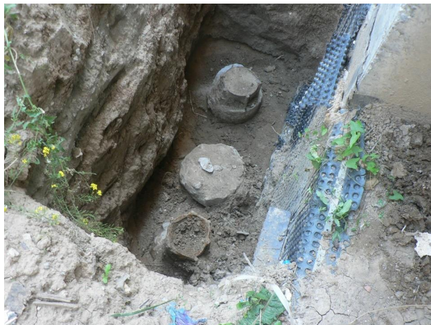
Рисунок 7. Внешний вид железобетонных свай №№ 3 и 4
