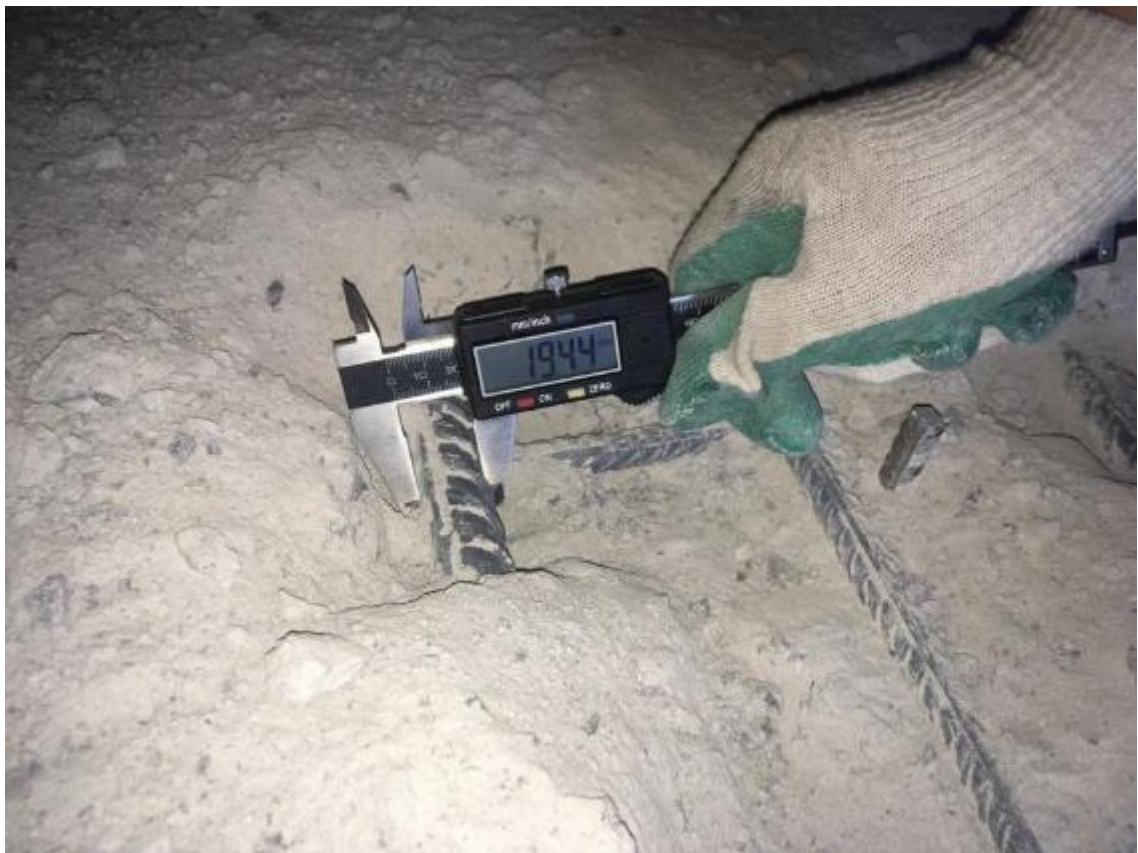
Фото 35. Определение диаметра рабочей арматуры в перекрытии 18-этажной части здания в осях 1-20, А-Д
